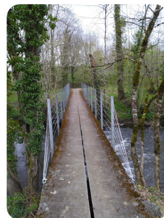
La passerelle de la Loue : Une inspection détaillée a été réalisée pour garantir la sécurité des promeneurs sur cet ouvrage essentiel et les câbles ont été changés.
